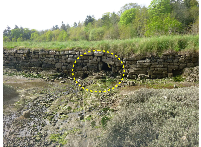
OH4 - trop-pleins vue amont
