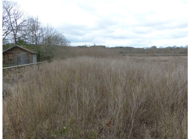
Photo 21: section N de la digue de Lozèrez infranchissable en l'état, mars 2018 - ©Cerema
