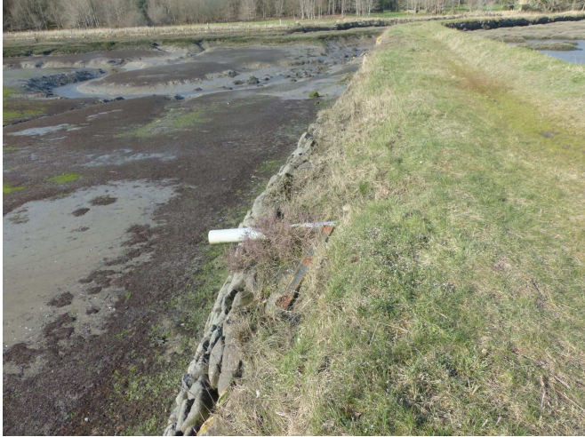
OH3 - tube PVC pour le drainage de la digue
