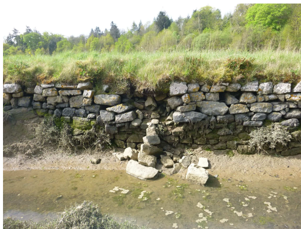
Photo 12: éboulement en amont, avril 2018 ©Cerema
