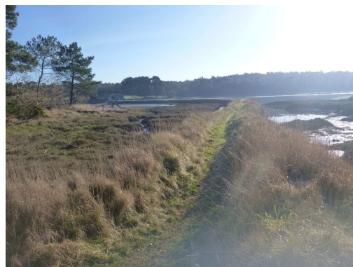
Photo 19: sente à l'extrémité W de la digue de Béquerel, février 2018 - ©Cerema
